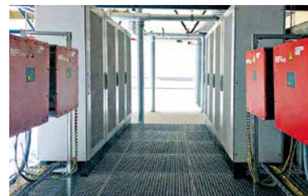
Das Energiespeichersystem besteht aus Schaltschrank, Batteriemodulen, Wechselrichtern und vielen Metern Kabel.
